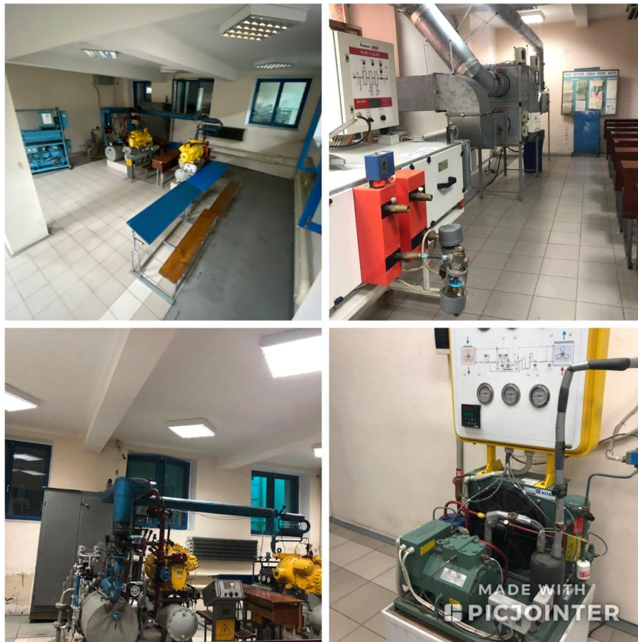
Фото30. Лабораторії холодильних установок і кондиціонування повітря..
